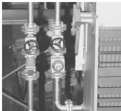
Einsatz an einem Luftheizer in einer Hallenbeheizung
